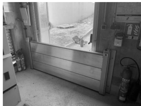
Local Haute tension
