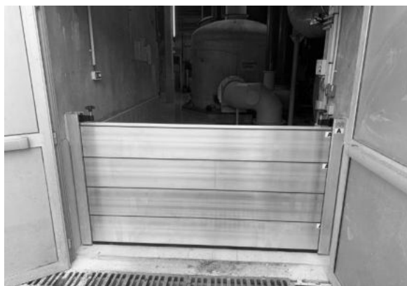
Entrée local désodorisation
