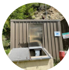
Réservoir les Tardons (40 m³)
