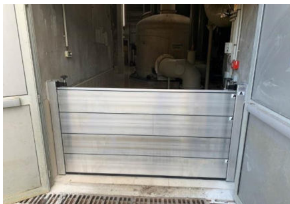
Entrée local désodorisation
