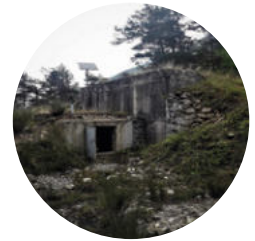
Réservoir Ubac (20 m³)
