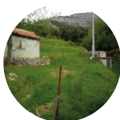
Réservoir Bas Village (150 m³)
